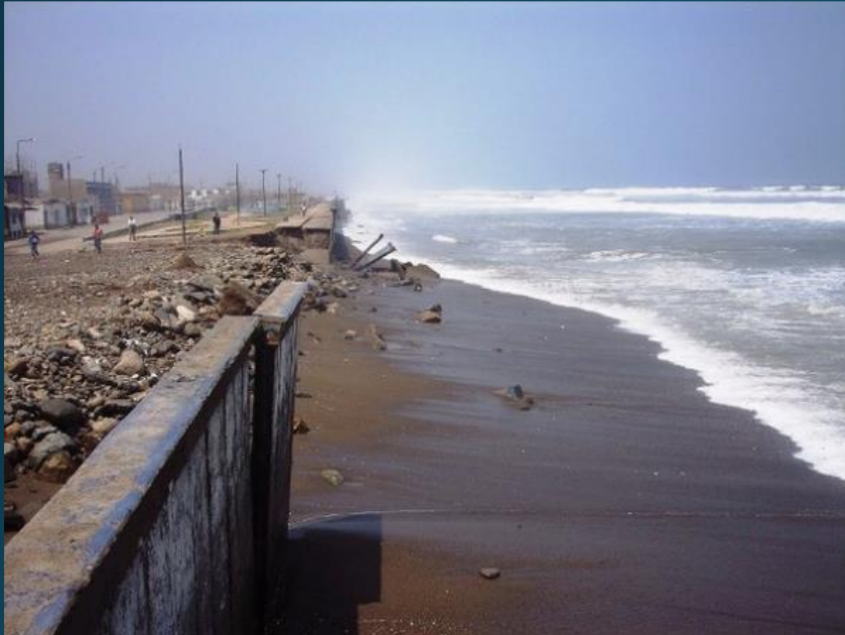
Problemas de erosión
